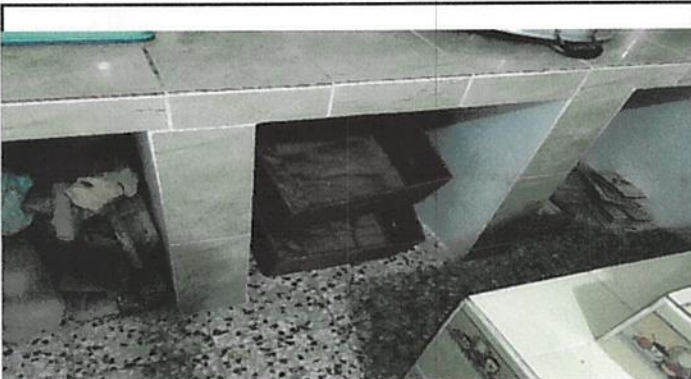
Foto 3: se necesitan puertas en los estantes de la cocina
