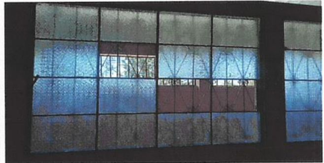
Foto 2: ventanas del aula estan dañadas
